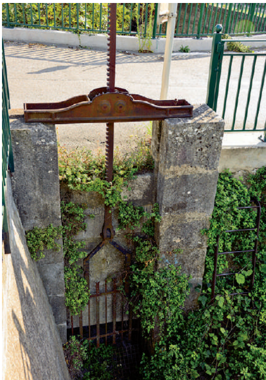
Ancienne vanne n° 7 quartier Saint-Joseph
